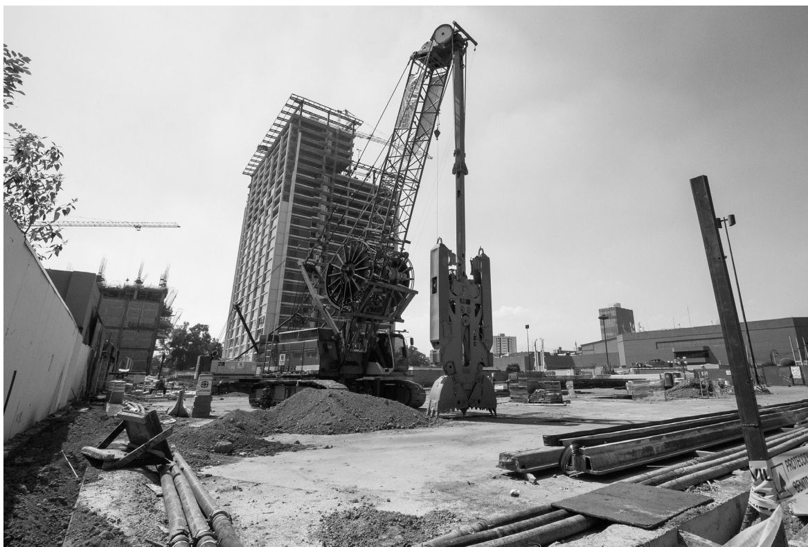
PROMETEO LUCERO ▶ Primera etapa de la construcción de la Torre Mitikah en el pueblo de Xoco. Ciudad de México, abril de 2012.
